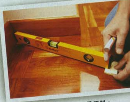
▲上水御皇庭的單位地板嚴重傾斜。
