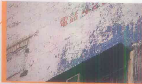
大廈外牆滿佈裂縫，屋宇署表示會發信勸諭外牆業主加以修葺。(黃錦明攝)
