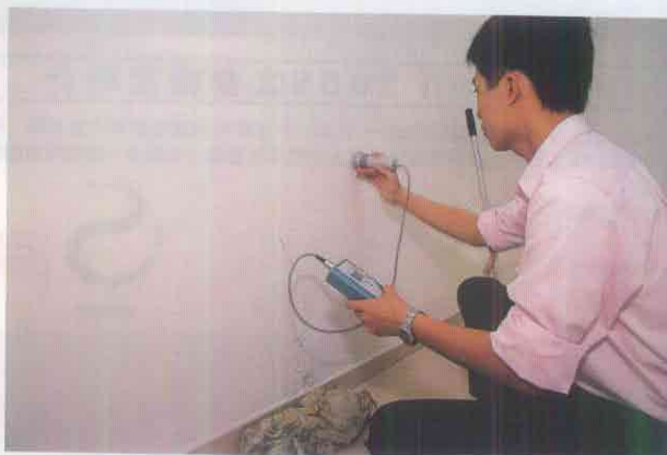
建科測試儀器有限公司利用微波掃描器，檢測了牆身裂縫附近一米乘一米的範圍，證實牆身內滲水情況嚴重。(黃維攝)
