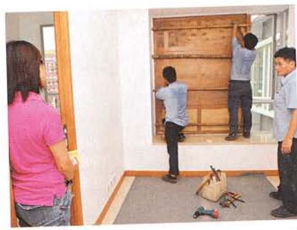
樂悠居的發展商為華人置業，業主陳小姐收樓未夠半年，落地玻璃竟無端碎裂。（吳文正攝）
