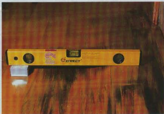
走廊的橡木地板嚴重發黑，高低位相差三十毫米，慘不忍睹。(黃穎珊攝)
