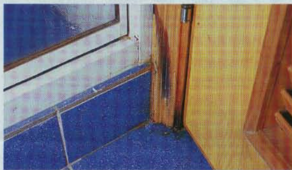
去年六月，博策曾派人上門檢查，並在浴室門邊塗上防水油，但並未根治企缸滲水的問題。(黃穎珊攝)
